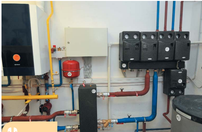
В теплогенераторных установках используется современное оборудование голландской фирмы Rendamax
