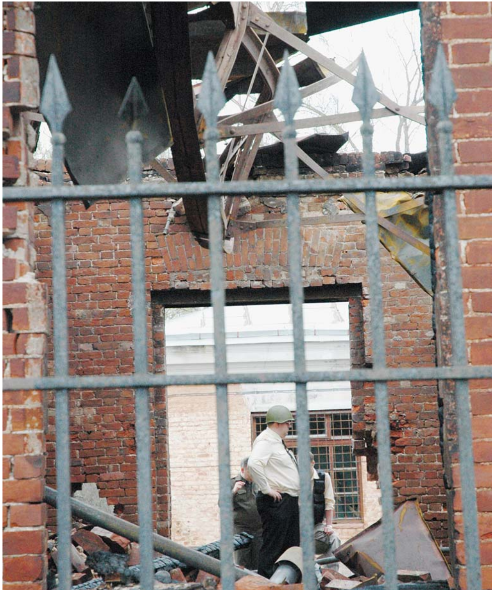
После взрыва боеприпасов на заводе в Кронштадте
