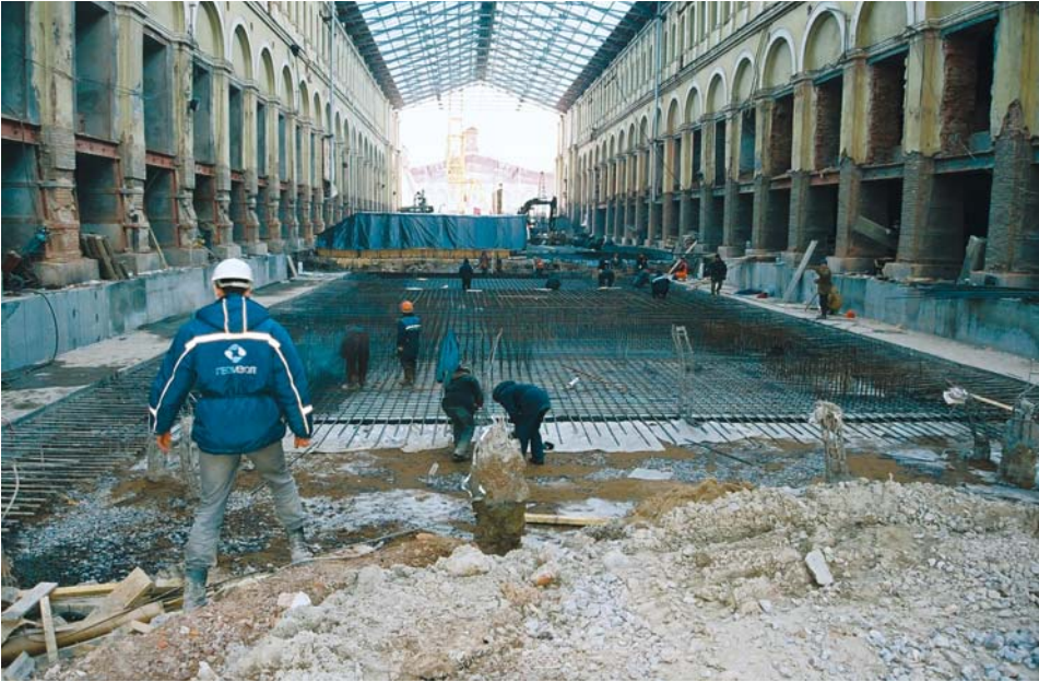
Реконструкция Варшавского вокзала. Работы по бетонированию плиты основания с последующим нанесением обмазочной гидроизоляции
