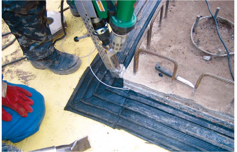
Торгово-развлекательный комплекс – Транспортный пер., 3. Гидроизоляция фундамента. Монтаж геомембраны с уплотняющим ПВХ профилем
