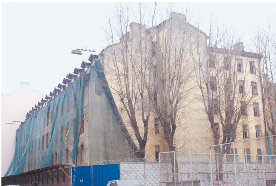
В Адмиралтейском районе на Большом Казачьем переулке реконструируется существующее здание. Расселение и проектирование выполнены полностью, началась прокладка инженерных сетей и благоустройство территории
