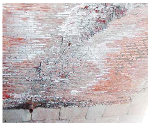
Разрушение кирпичного свода Аничкова моста через р. Фонтанку по Невскому пр.
