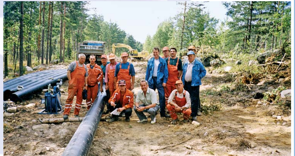
Водовод от озера Пионерское до Приморска с подключением порта Балтийской трубопроводной системы
