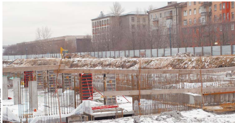
Продление сроков строительства жилого дома северо-западнее пересечения Варшавской и Благодатной улиц было необходимо из-за проведения работ по радиозащите и деактивации земельного участка
