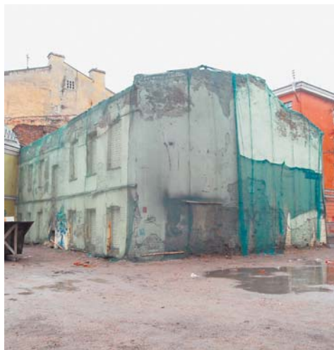
На участке расположены здание склада библиотеки для слепых и полуразрушенное здание, территория не благоустроена
