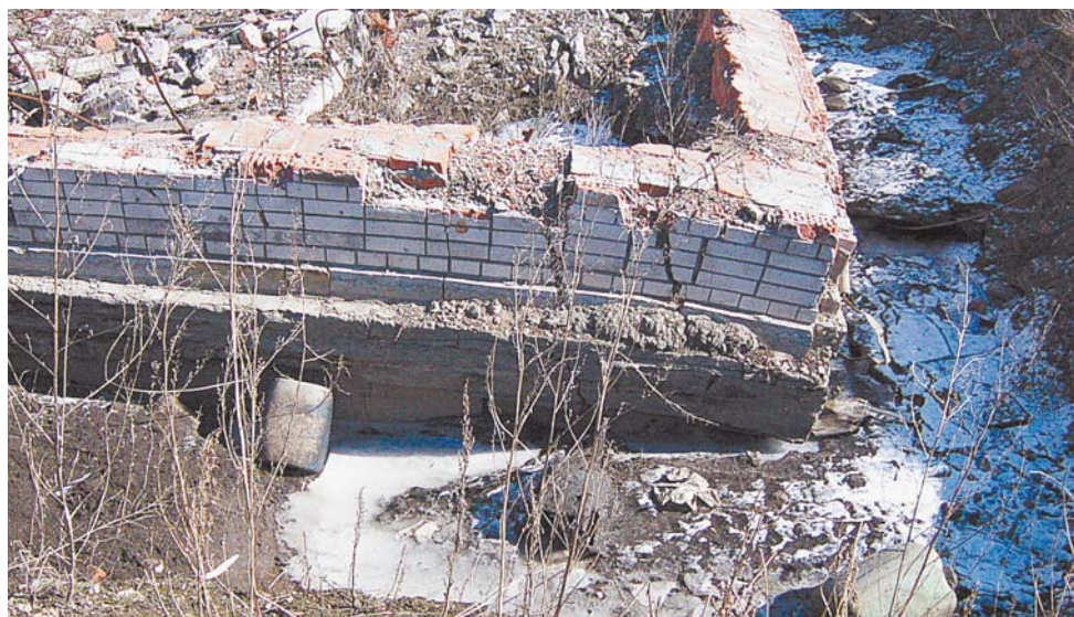
Вот так изгибается фундамент, частично оказавшийся в зоне тектонического нарушения (Двинская, 8)
