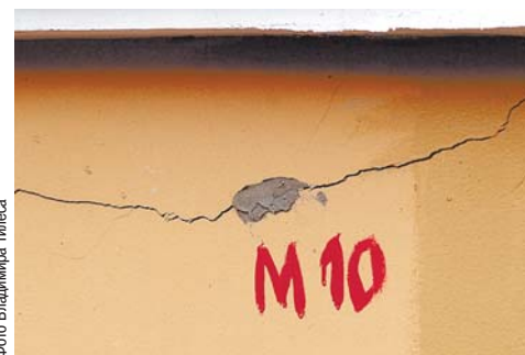
С декабря прошлого года были отмечены трещины на стене Юсуповского дворца
