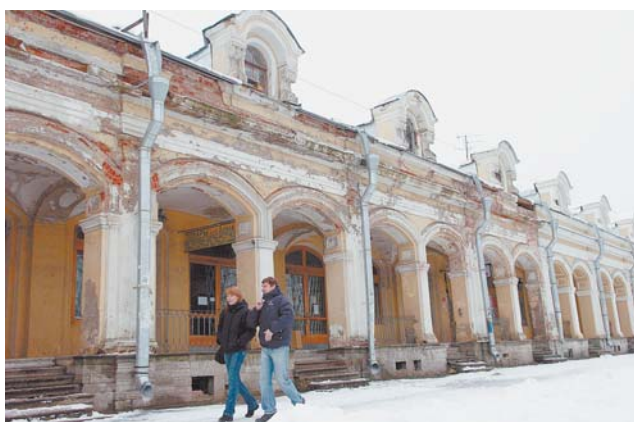
Отремонтировать фасады Гостиного двора арендаторы обещали еще три года назад
