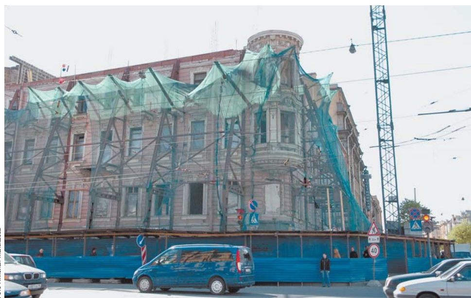
На Литейном пр., 5/19, лит. А, ООО «Адамант» реконструирует здание под гостиницу. Теперь срок ввода гостиницы в эксплуатацию переносится на декабрь 2009 года
