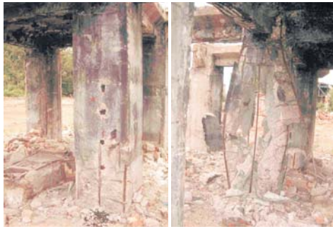
Разрушение железобетонной колонны
