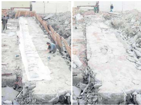
Разрушение фундамента повышенной прочности
