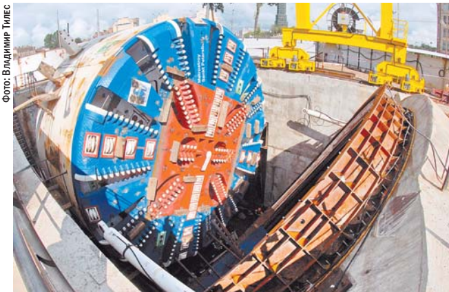
Использование ТПМК обеспечило безопасность окружающей застройки при сооружении наклонного хода ст. метро «Обводный канал»
