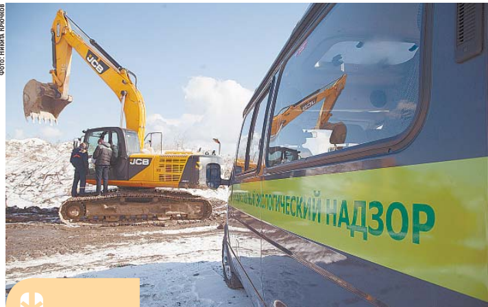
18 марта, граница пос. Разметелево и Мяглово во Всеволожском районе, где систематически незаконно копают песок. По словам водителей техники, их «забросили» сюда, не объяснив, чем именно они будут заниматься
