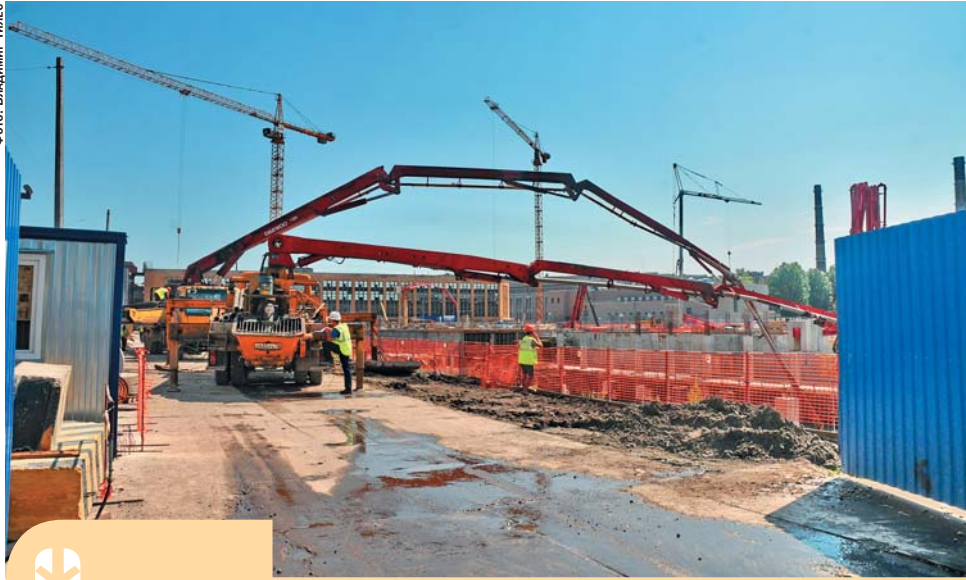
Проведение фундаментных работ в Петербурге требует от компаний большого профессионализма и отлаженного технологического процесса
