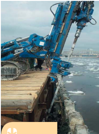
Работы по капитальному ремонту стенки Синопской набережной на участке от Херсонского проезда до пирса у Большеохтинского моста
