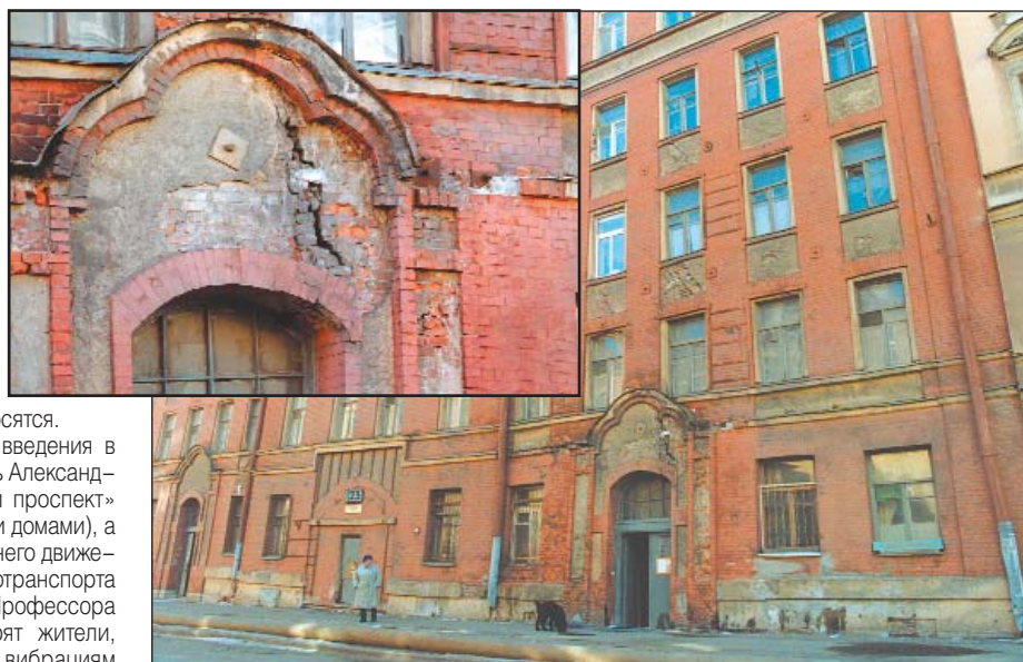
Трещины, пронизывающие жилые дома на Тележной улице, вблизи которых предполагается построить бизнес-центр
