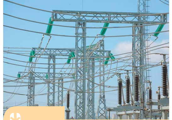
Подстанция с открытым распределительным устройством 330 кВ
