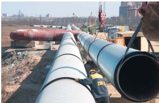
Теплотрасса, пос. Ольгино
