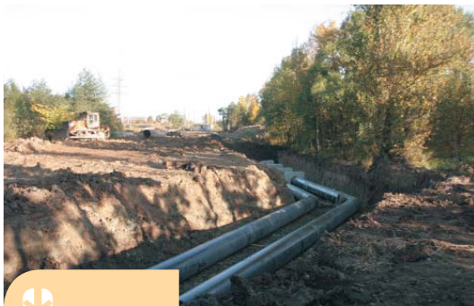
Реконструкция газопроводов в зоне строительства транспортных развязок на пересечении КАД с Пулковским шоссе
