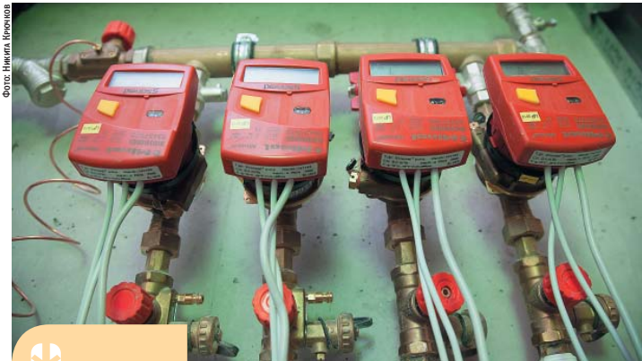
Затраты на внедрение энергосберегающих технологий могут окупиться в процессе эксплуатации объекта
