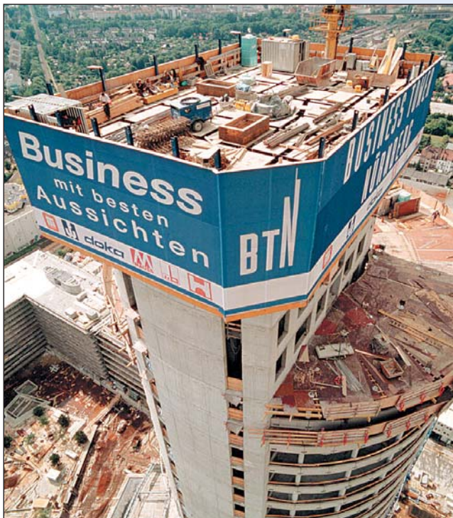
Офисный центр Нюрнберг, Германия, высота 133 метра
