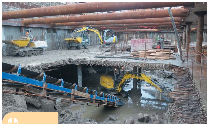
Площадка строительства Арбитражного суда г. Санкт-Петербурга и Ленинградской области по адресу: ул. Смольного, 6, вид «изнутри»
