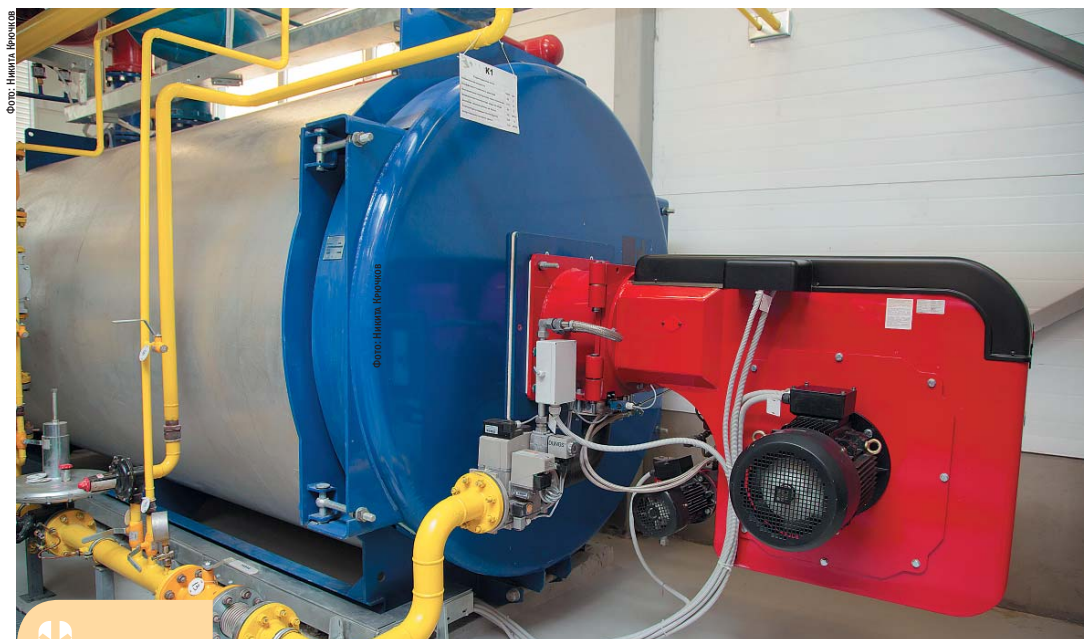
Газовые котлы удобны и дешевы в использовании, но в случае размещения объекта в негазифицированном районе появляется необходимость использования котлов на альтернативном топливе: электричество, дизель, твердое топливо
