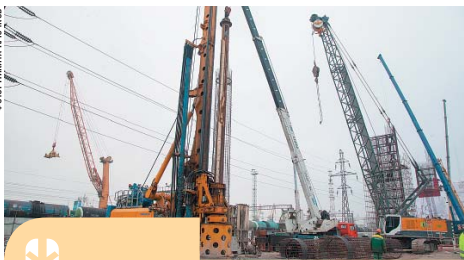
Работа по двум из восьми опор под эстакаду, которые ЗАО «Геострой» должно построить на участке ЗСД на Канонерском острове, уже завершена
