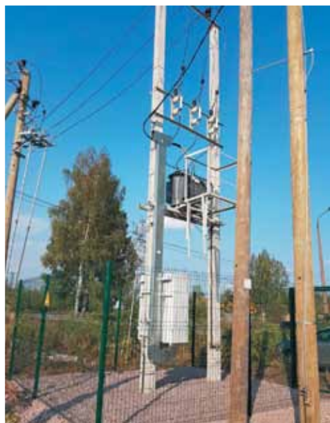
Новая МТП 6/0,4кВ построена в городе Лодейное поле для АО «ЛОЭСК». В сентябре 2019 года планируется ее включение под рабочее напряжение и ввод в эксплуатацию.
